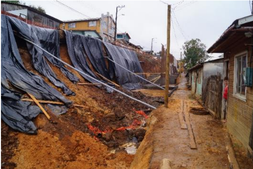
Figura 47. Deslizamientos de Tierra en Sector Cerro La Perdiz, Calle Manuel Montt.
