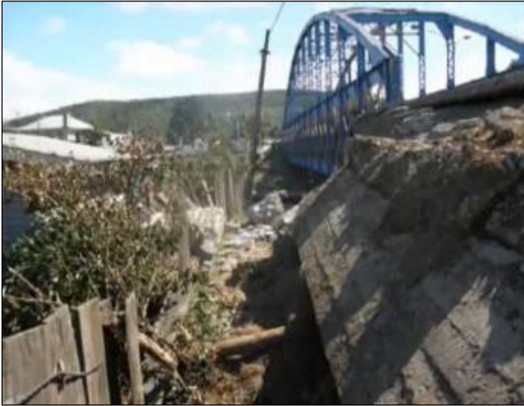
Figura 37. Agrietamiento en terraplén puente “La Máquina” río Curanilahue.
