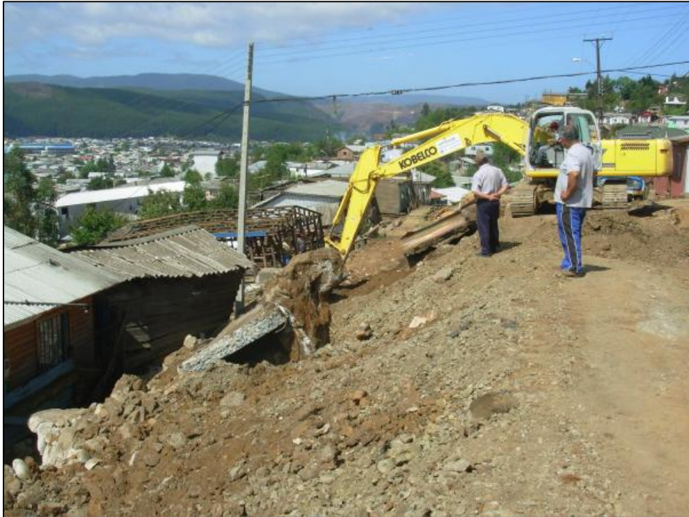
Figura 46. Caída de terraplén en Calle Manuel Montt.
