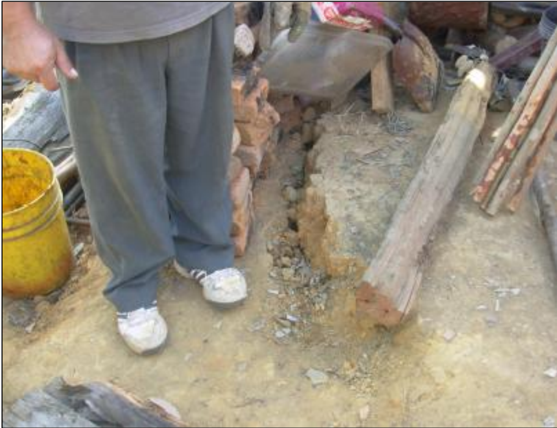
Figura 45. Grietas en sector cerro verde
