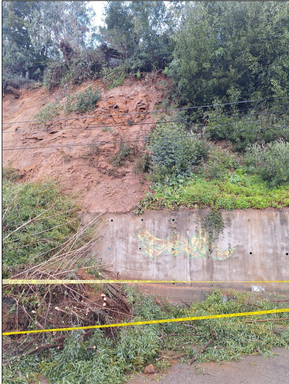
Figura 42. Deslizamientos Calle Arauco
