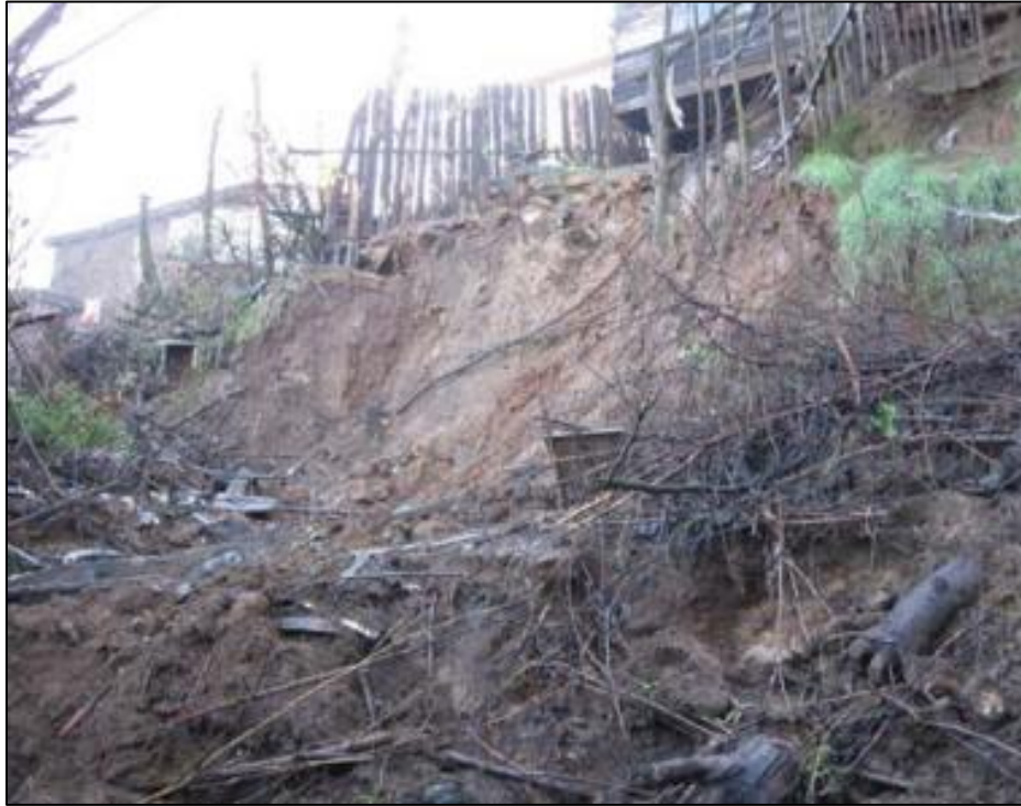
Figura 38. Deslizamientos Callejón Pilar
